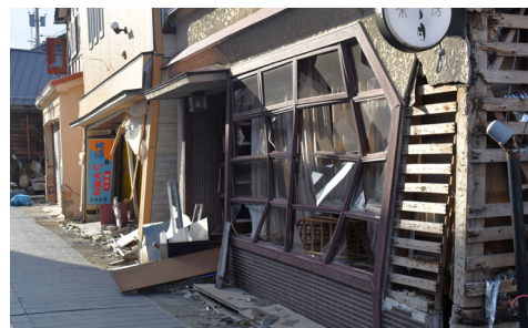
割れたガラスもそのまま残る店舗=7月1日、輪島市内
